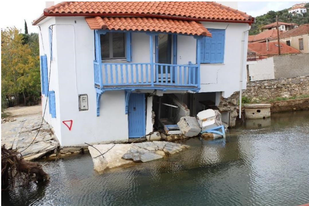
Διώροφο σπίτι που έγειρε στην κοίτη του χειμάρρου και κατέρρευσε εν μέρει.
